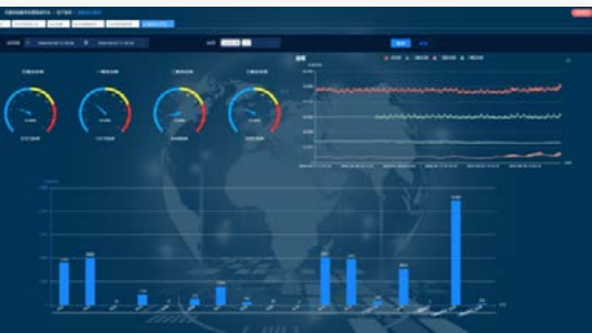
能源管理系统监控界面
